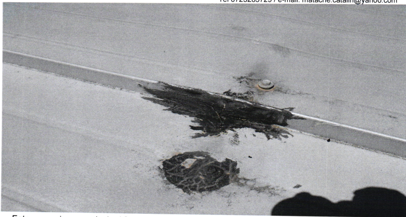
Foto acoperiș corp principal Sală de sport – deficiențe apărute la învelitoare panouri termoizolante
